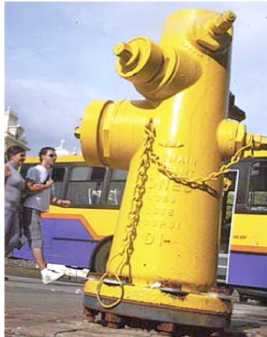
Foto No.1. Hidrante barril húmedo multivalvular
