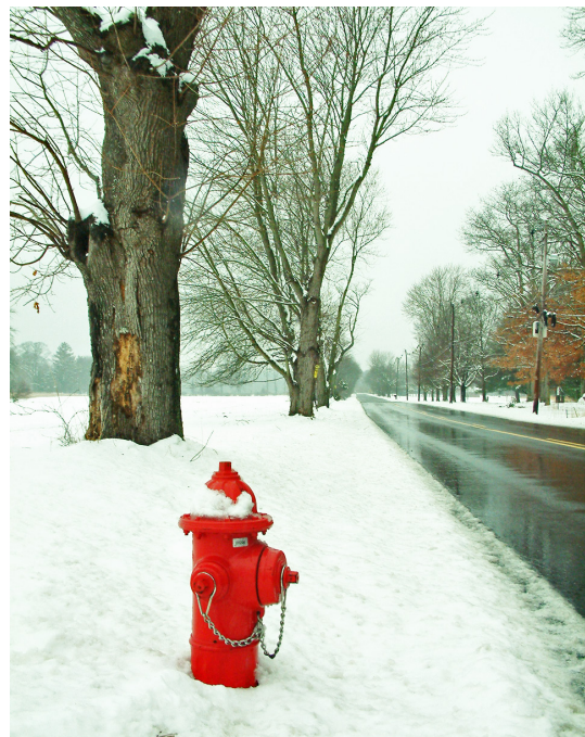
Foto No.2. Hidrante de barril seco
