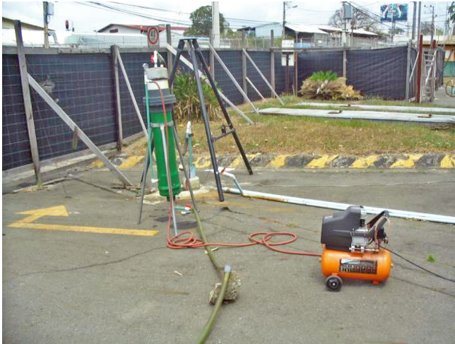
Foto No.8. Torre de desorción por burbujeo de aire
