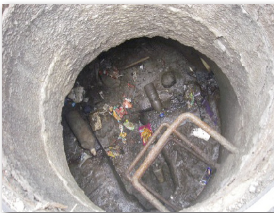
Colector de alcantarillado sanitario para aguas residuales.
