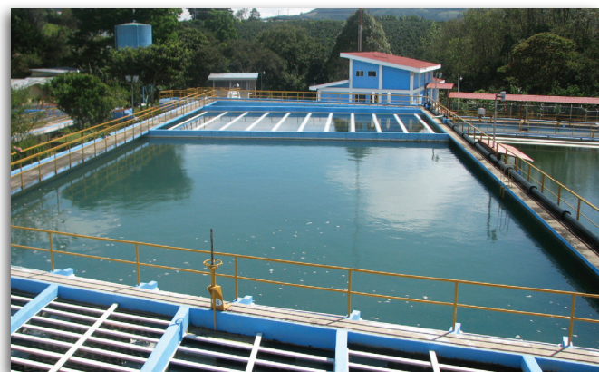
Planta de tratamiento de agua potable, Tres Ríos.
