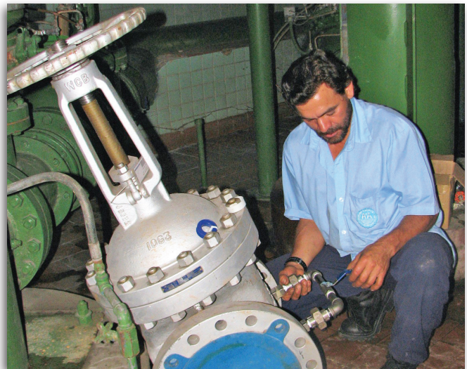
Estación de Bombeo, Puentes de Mulas, Belén de Heredia.
