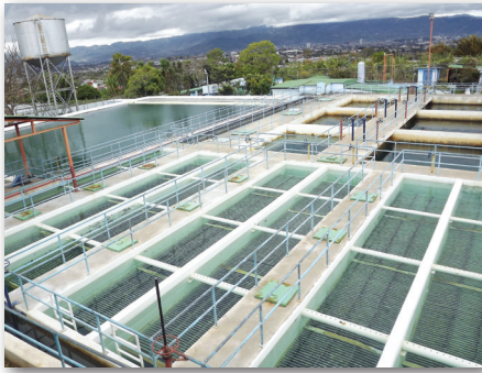
Planta tratamiento de agua potable, Los Sitios, Moravia.
