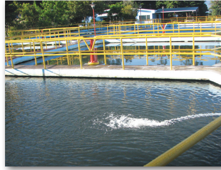
Planta tratamiento de agua potable, Guadalupe.
