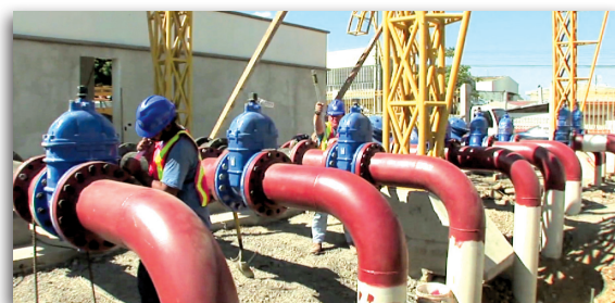
Equipos de bombeo, Santa Ana.
