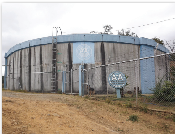
Tanque de agua potable La Pelota, San Miguel de Desamparados.
