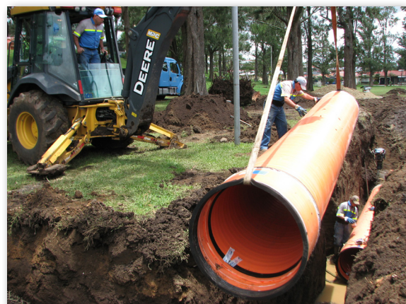
Tubería de alcantarillado sanitario para aguas residuales.
