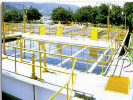
Planta de tratamiento de agua potable, Cartago.
