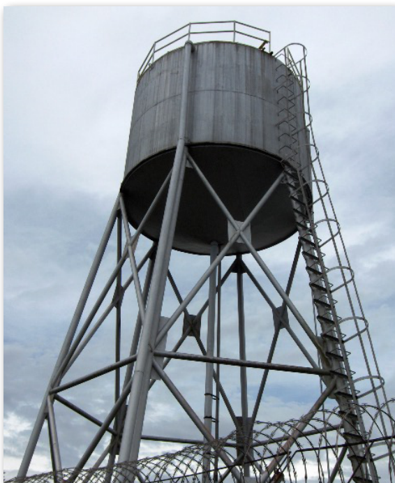
Tanque elevado, Parrita.
